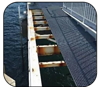
< 剥れた桟橋の床 >
